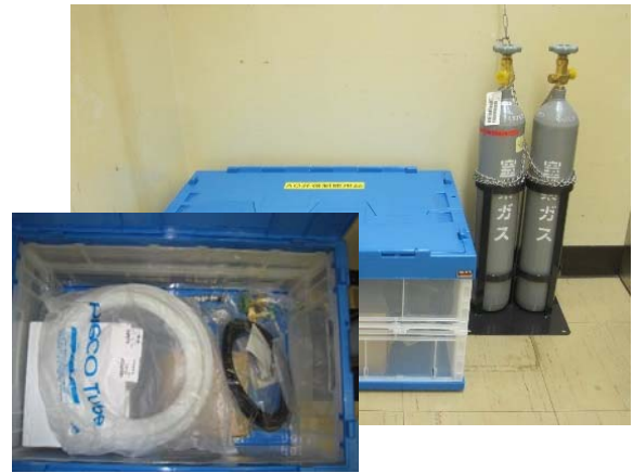
空気作動弁強制操作の資機材配備（福島第二） （圧縮空気ポンプ、接続用ホース、接続部品等）
