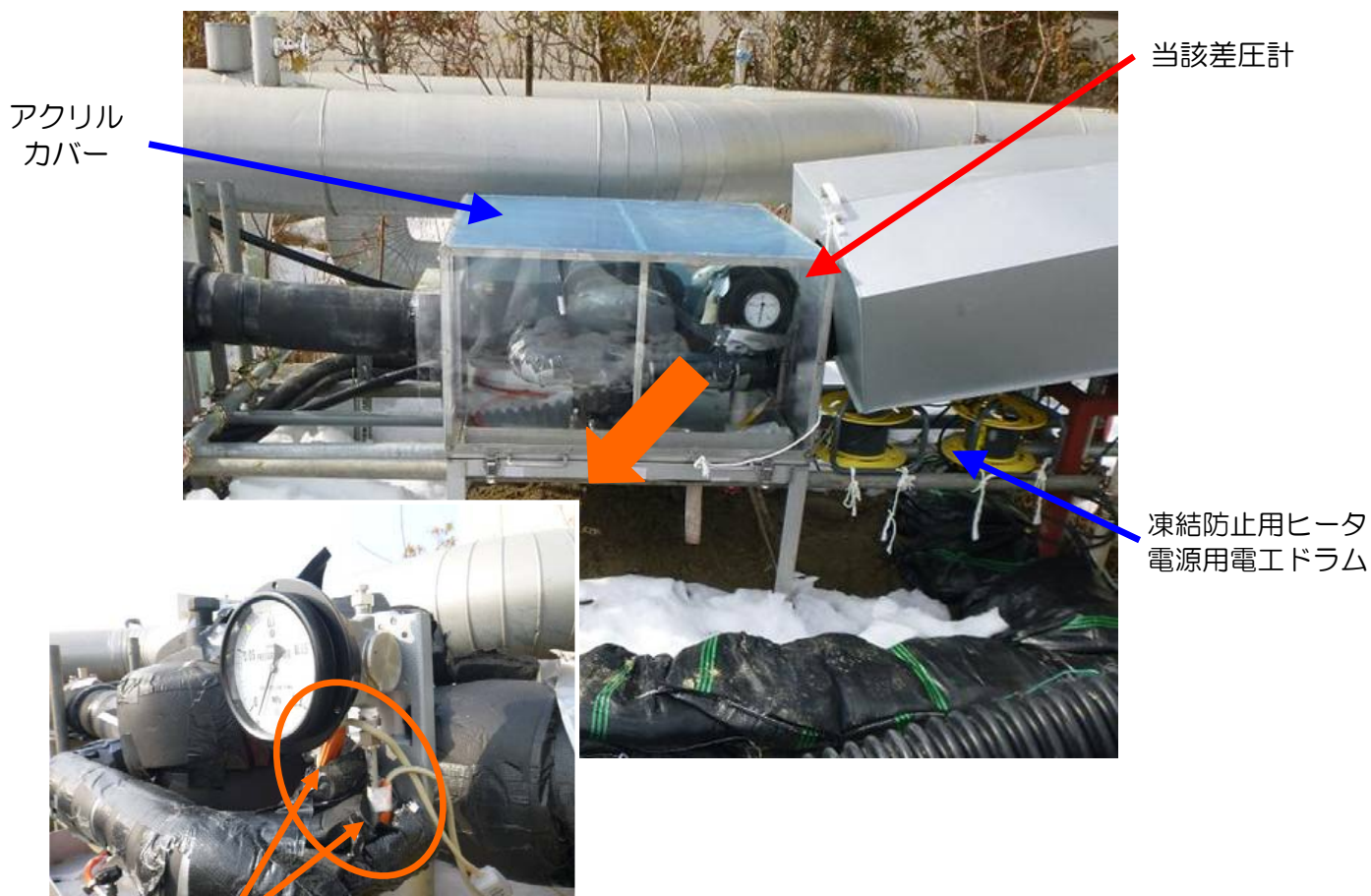
凍結防止用ヒータ（写真は当該差圧計本体への保温及び亚克力カバー取付前の状態）
