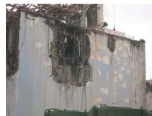
④外壁一部剥落
