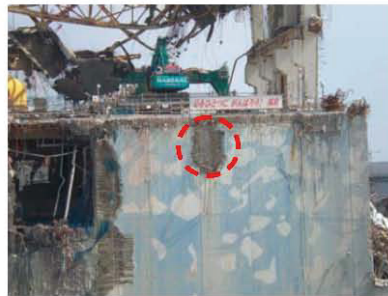
④外壁一部剥落
