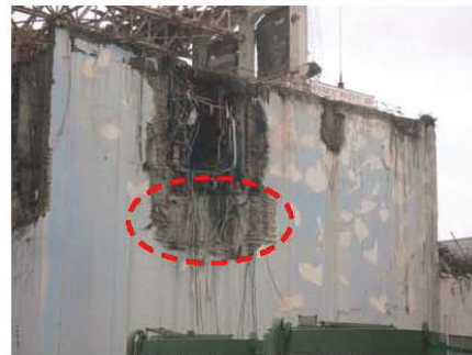
④外壁一部剥落
