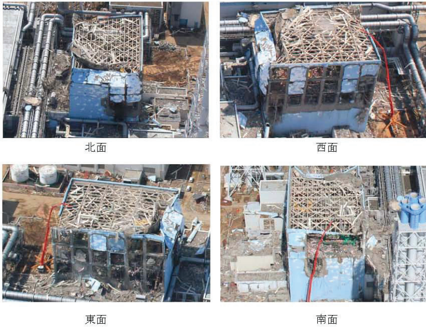
図1 損傷状況 (3月24日撮影)
