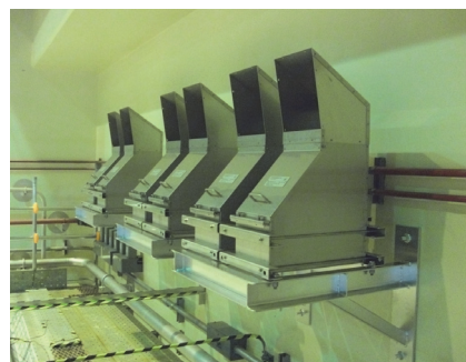
6号機 原子炉建屋水素処理設備
