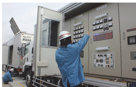
ガスタービン発電機車の起動操作
