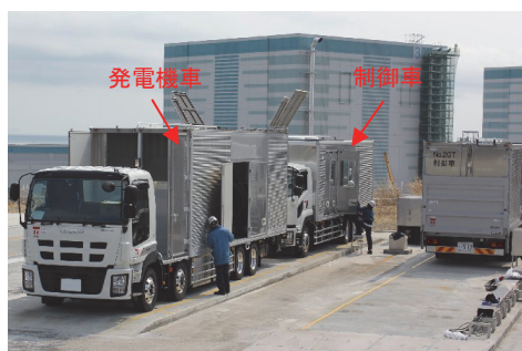
ガスタービン発電機車： 発電容量(4,500kVA)は、一般家庭約1,500軒分の消費電力に相当
