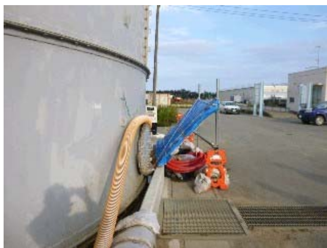
【歩廊から滴下した水を堰内へ導くためのシート設置状況】
