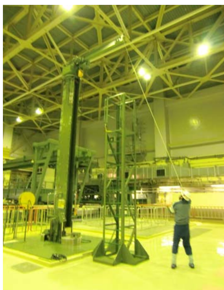
新燃料検査台
