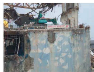
④外壁一部剥落
