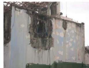
④外壁一部剥落
