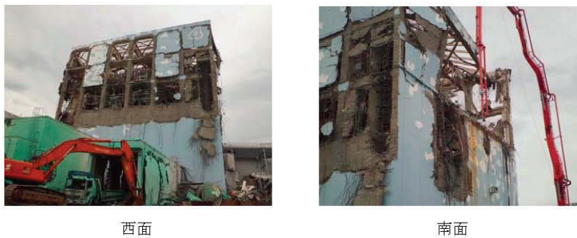
図2 西面・南面の損傷状況 (5月10日撮影)
