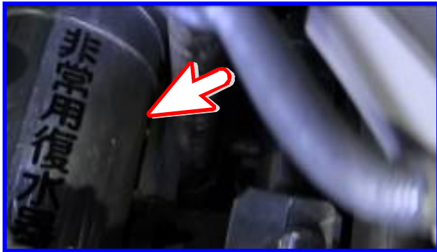
非常用復水器(B)凝縮水戻り配管
