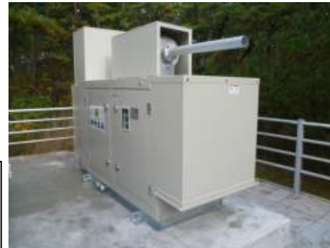
モニタリングポスト 電源バックアップ用発電機
