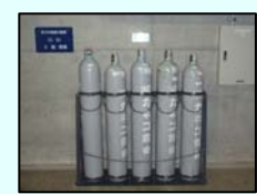
予備窒素ポンベを 1プラントにつき5本配備 設置場所(1号機の例) 原子炉建屋付属棟2階 (非管理区域、T.P.12.8m)
