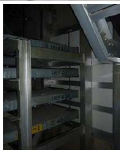
ケーブル トレイ 施工例
