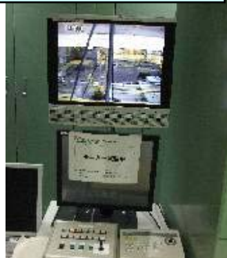
モニター (中央制御室)
