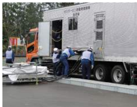
GTGによる電源供給訓練風景
