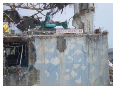
④外壁一部剥落
