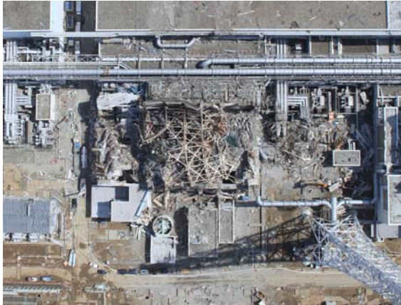
写真1 第3号機原子炉建屋の損傷状況 (平成23年3月24日撮影)
