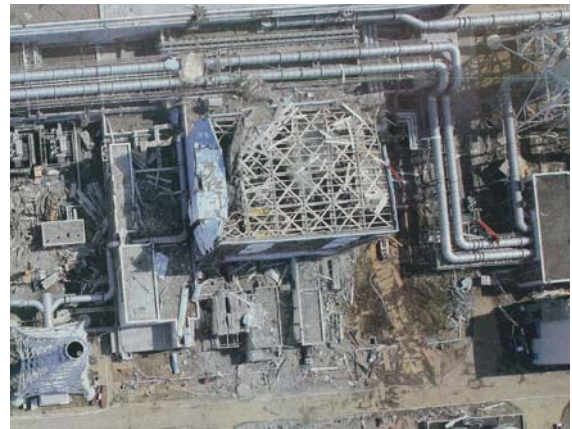
写真2 第4号機原子炉建屋の損傷状況 (平成23年3月24日撮影)
