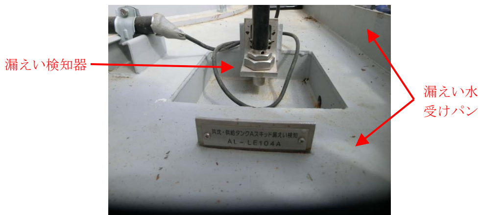
図3 漏えい検知器の設置状況（一例）
