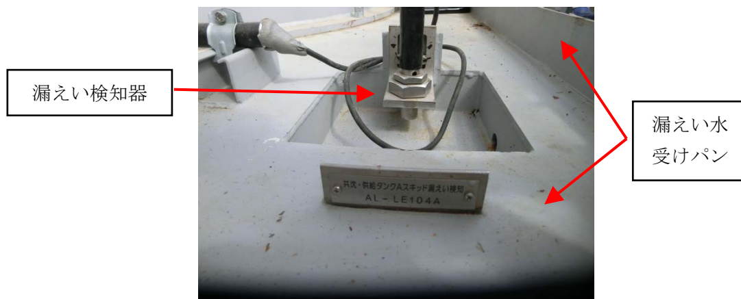
図6 漏えい検知機の設置状況 (一例)
