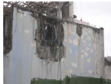
④外壁一部剥落
