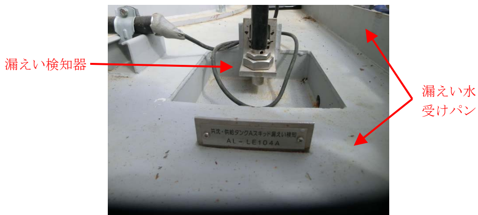
図3 漏えい検知器の設置状況（一例）
