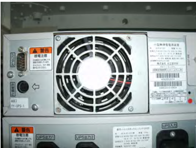
UPS 背面ファン (排気ファン)
