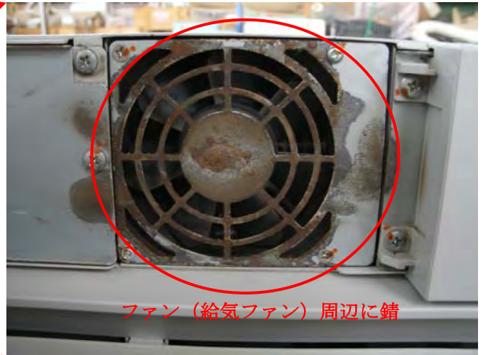
UPS 正面 (ファン周辺部)
