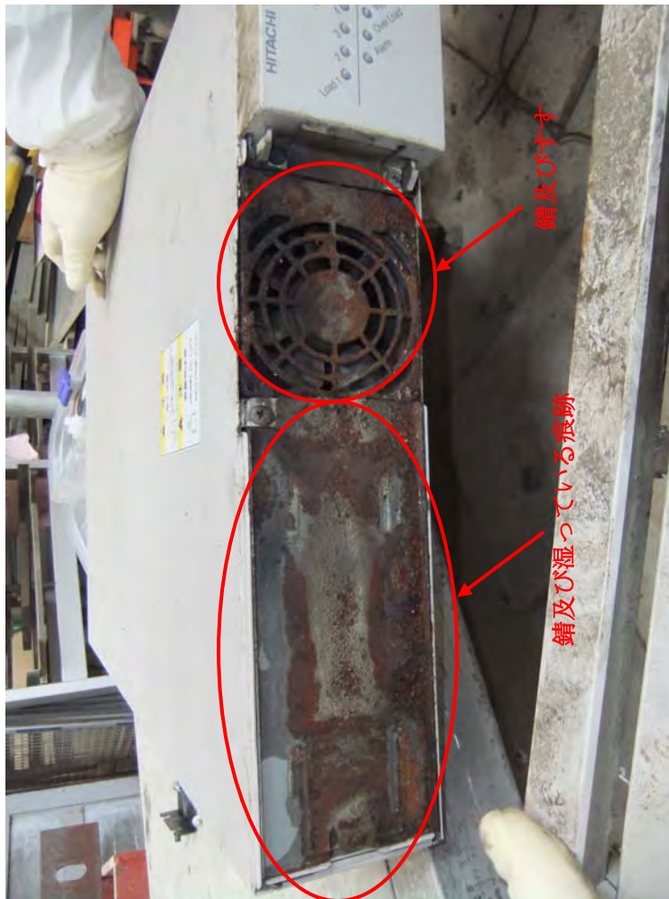
UPS 外觀 (正面カバー無)
