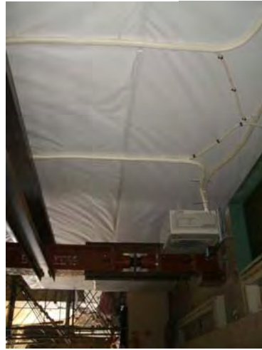
4号機エアコン(室外機)
