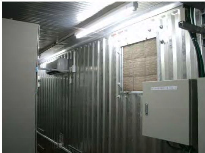
空調機、給気口
