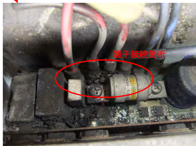
端子接続箇所拡大
