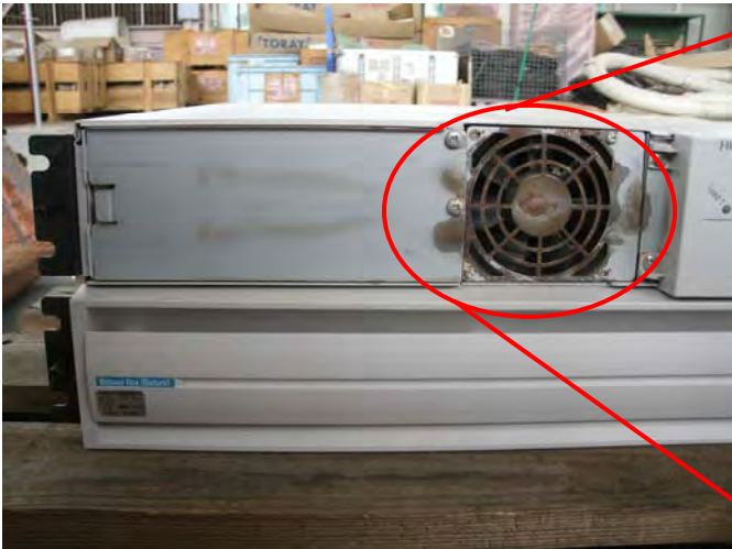
UPS 正面 (正面カバー取り外し状態)
