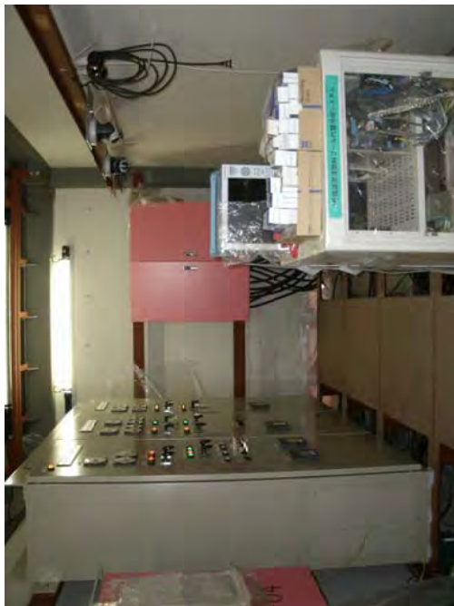
2号機制御盤 (コンテナ内)
