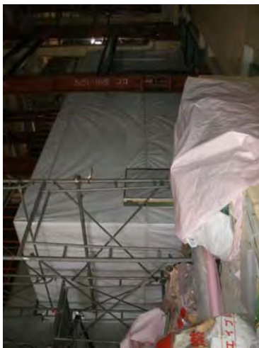
4号機 制御盤室外観
