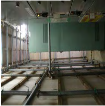
4号機制御盤室(室内)
