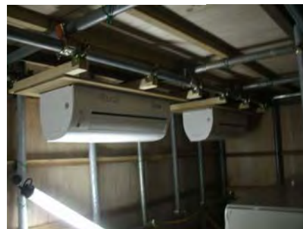
4号機エアコン(本体)
