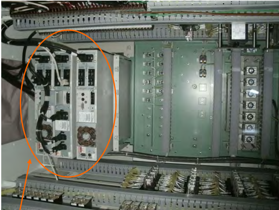
制御盤内部 (裏面)
