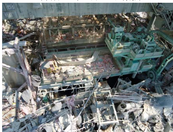
写真4 第4号機使用済燃料プール周辺の状況 (平成23年7月15日撮影)
