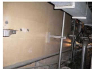
使用済燃料プールを支持する壁
