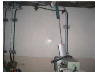
使用済燃料プールを支持する壁
