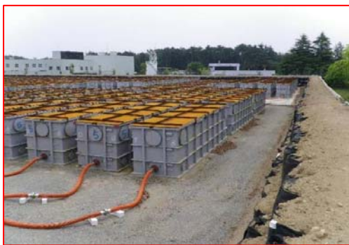
既設のEエリアタンク 16トン \sim 42 m^3 の鋼製角型タンク \times 295基 合計容量：8,000 m^3
