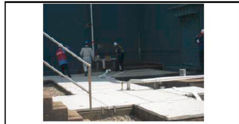
送水口に接続
