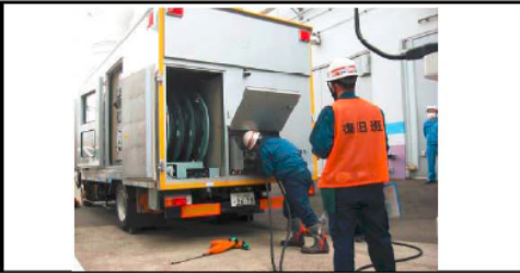
電源車へケーブル接続
