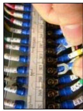
仮設スイッチ接続 端子
