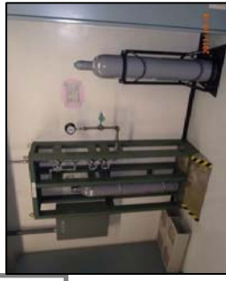
原子炉建屋地下1階 S/Cベント用空気ポンプ、予備ポンプ
