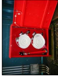
<ホース収納箱内部>
