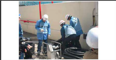
軽油タンクから抜き取り
