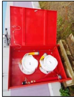
〈ホース収納箱内部〉
