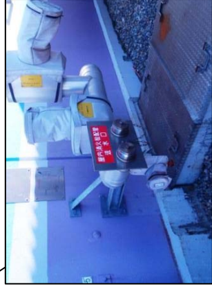
消火用連結送水口
