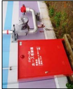
〈屋外消火栓とホース収納箱〉
