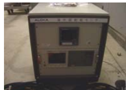
①可搬型海水モニタ (測定部)
