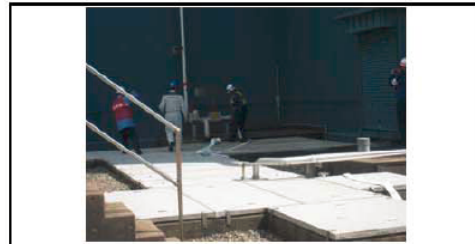
送水口に接続
