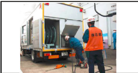
電源車へケーブル接続
