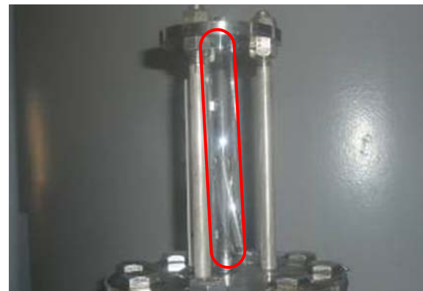
No.23: 純水装置 廃液ライン流量計
