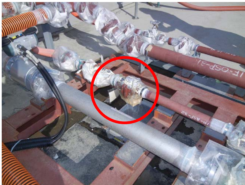
No.11 廃液供給ポンプ(B)ミニマムフローライン部
