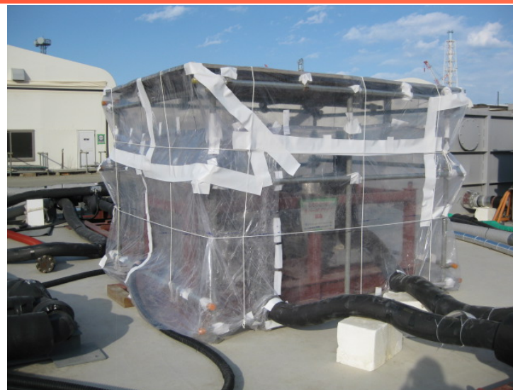
No.11,13 廃液供給ポンプ（対策後）
