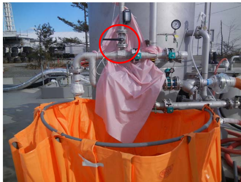
No.12 脱塩器入口ラインの弁フランジ部
