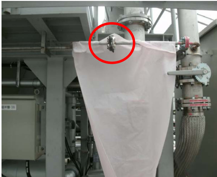
No.19 蒸発濃縮装置3Aシール水冷却器 出口ラインフランジ
