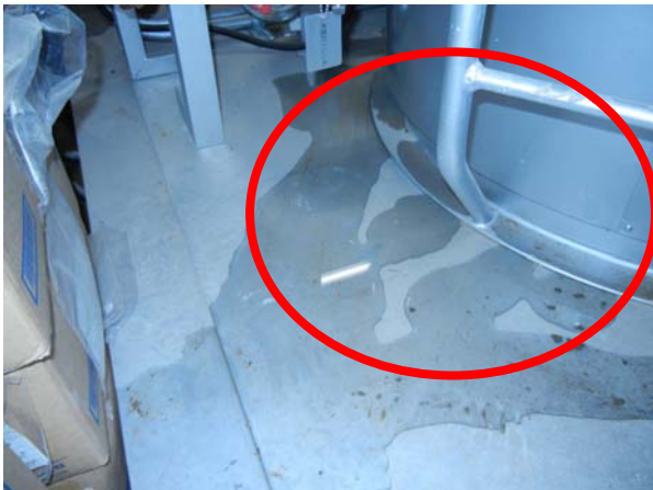
No.15,16ボイラー給水タンク周り
