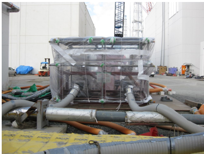
SPT受入水移送ポンプ（対策後）
