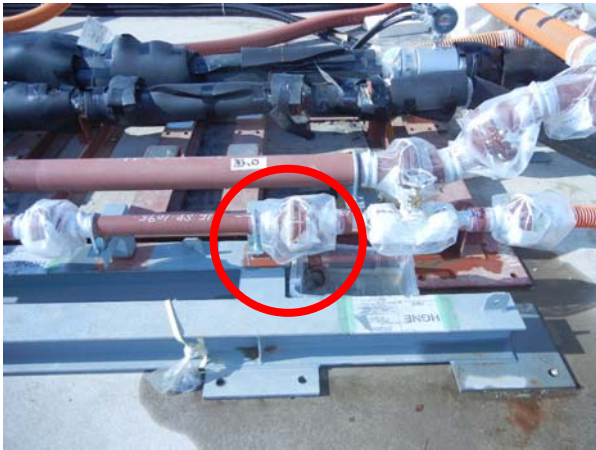
22 No.13 廃液供給ポンプ(A)ミニマムフローライン
