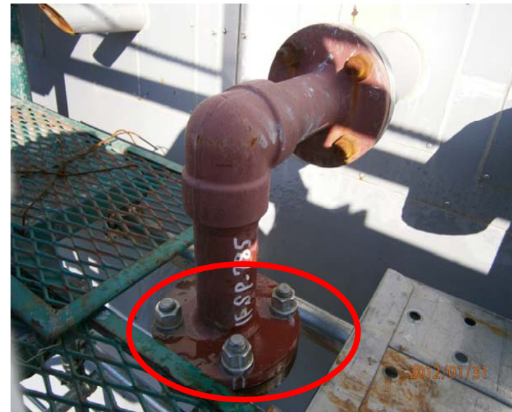
No.20 ボイラー凝縮水ラインフランジ
