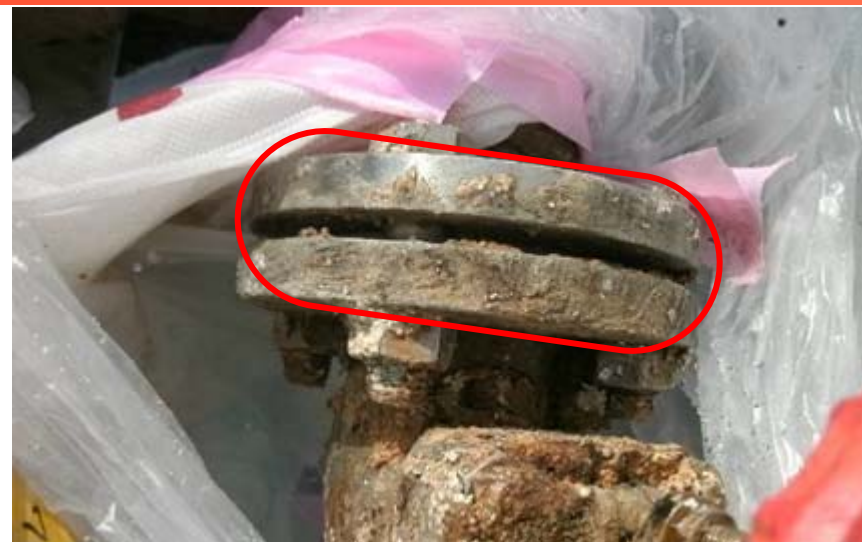
No.21: 6号機循環水ポンプモーター冷却水入口弁フランジ
