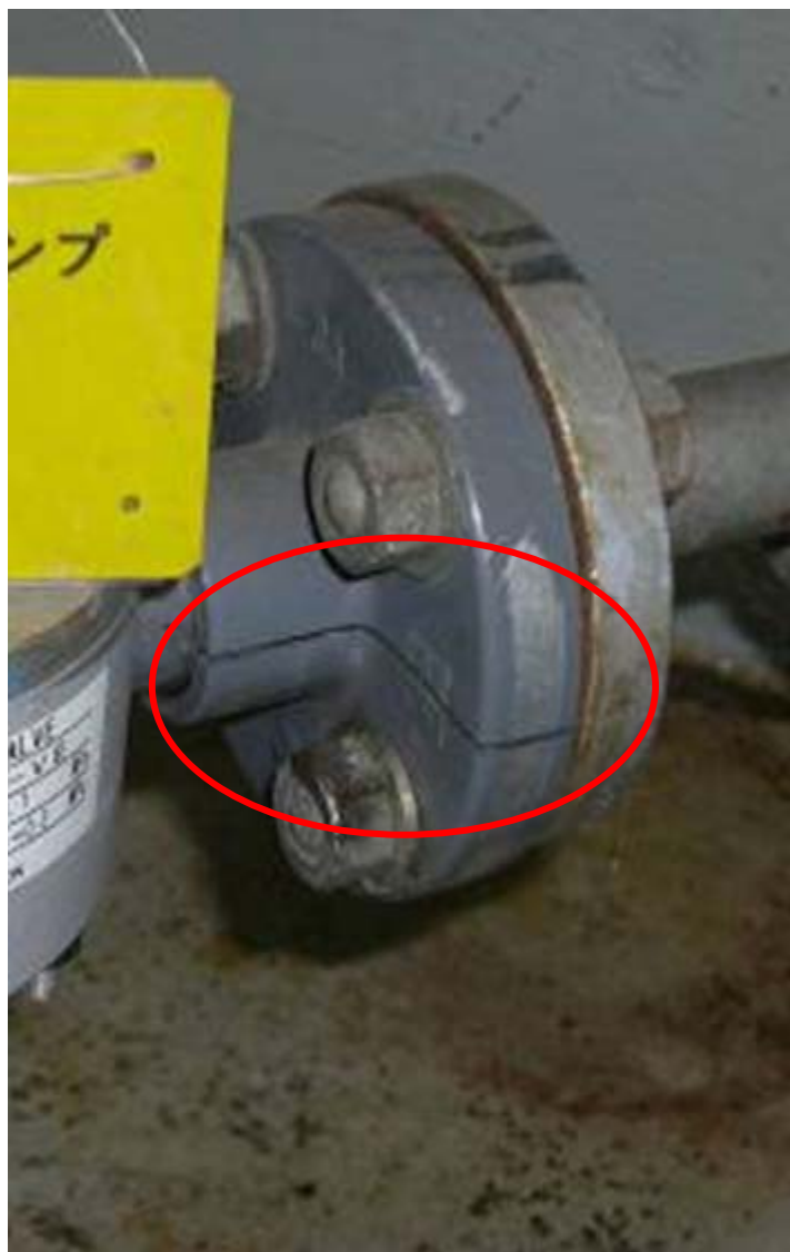
No.25: 純水装置 フランジ部
