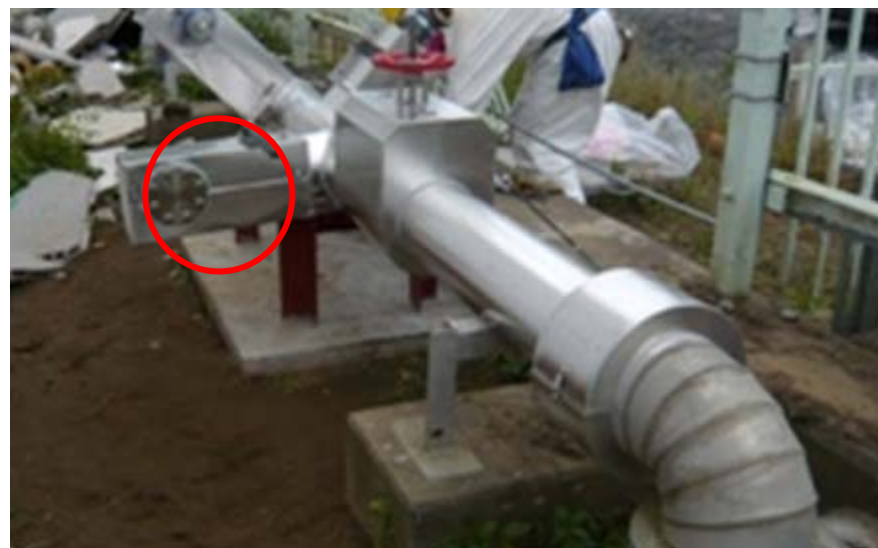
No.27: 純水供給用ヘッダフランジ部
