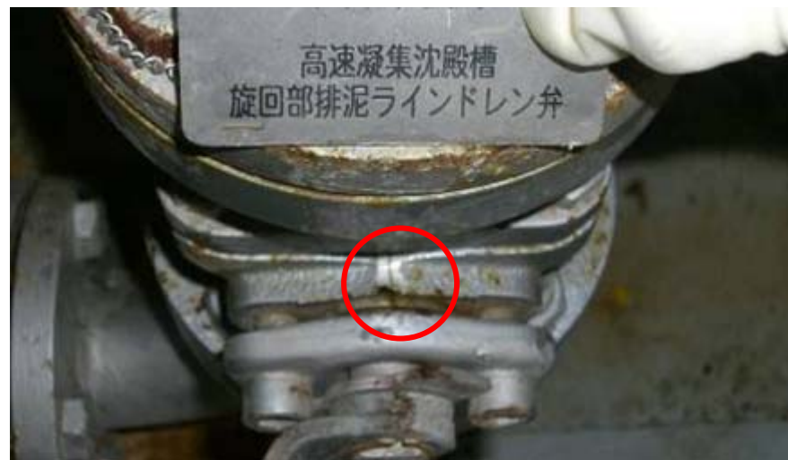
No.26: 純水装置 廃液ラインドレン弁
