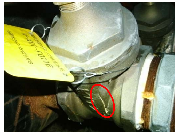
No.5: ろ過水供給ヘッダー仕切り弁B
