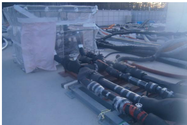
No.11,13廃液供給ポンプAミニフローライン（対策後）
