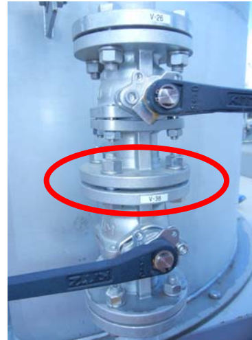
No.14 脱塩器樹脂移送ライン弁フランジ
