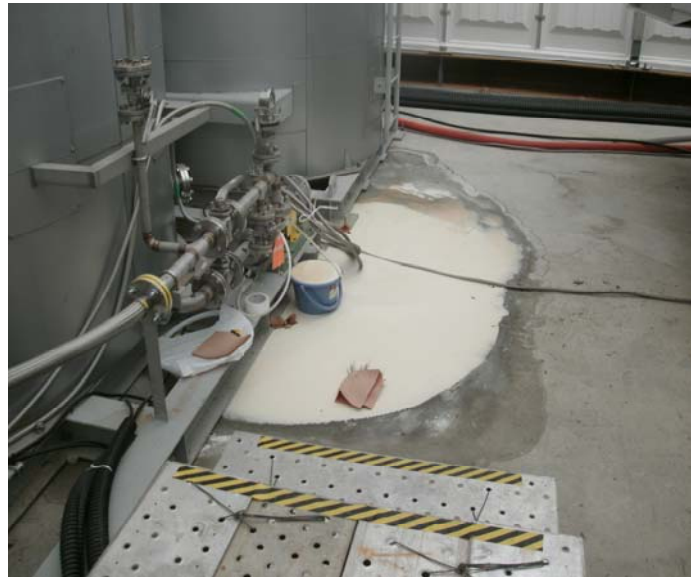
漏えい状況 (12/12 16時頃)
