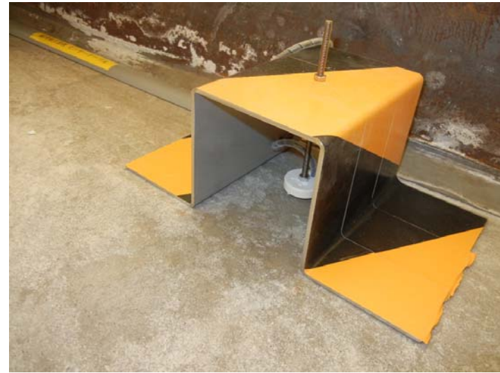
【蒸発濃縮装置2A, B用ハウス】
