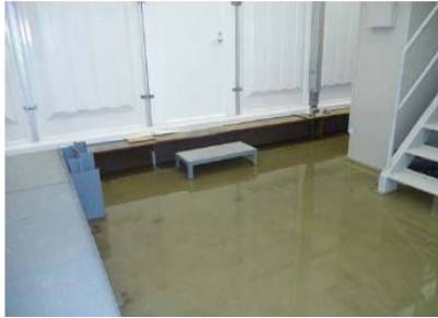
蒸発濃縮装置3A水漏れ時状況
