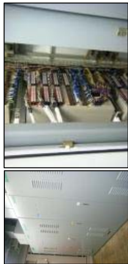
仮設スイッチ接続 現場盤
