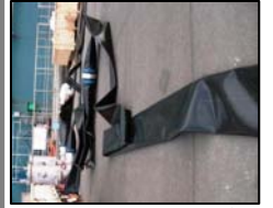
＜ 海水接続用仮設ホース ＞
