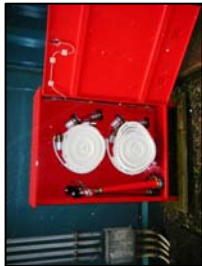
<ホース収納箱内部>
