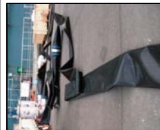
< 海水接続用仮設ホース >
