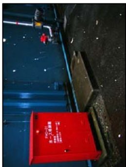
<屋外消火栓とホース収納箱>
