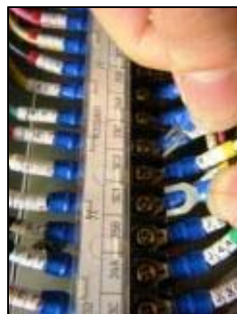
仮設スイッチ接続 端子
