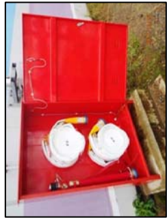
〈ホース収納箱内部〉
