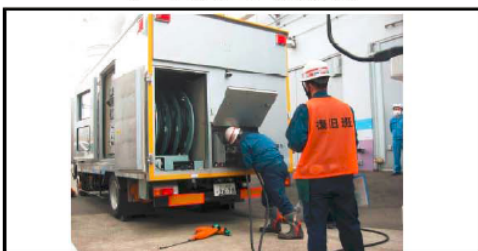
電源車へケーブル接続
