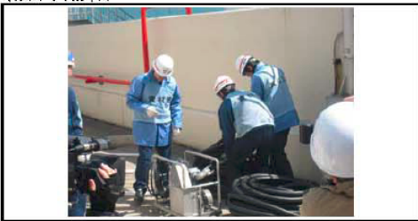
軽油タンクから抜き取り
