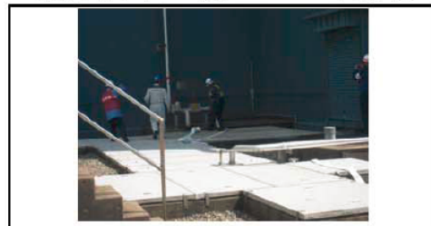
送水口に接続
