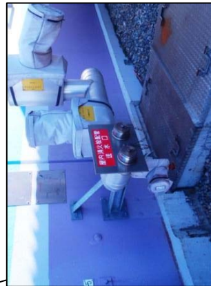
消火用連結送水口
