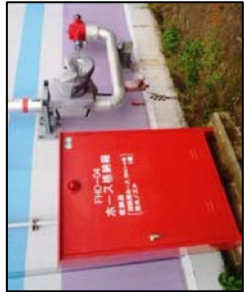
〈屋外消火栓とホース収納箱〉
