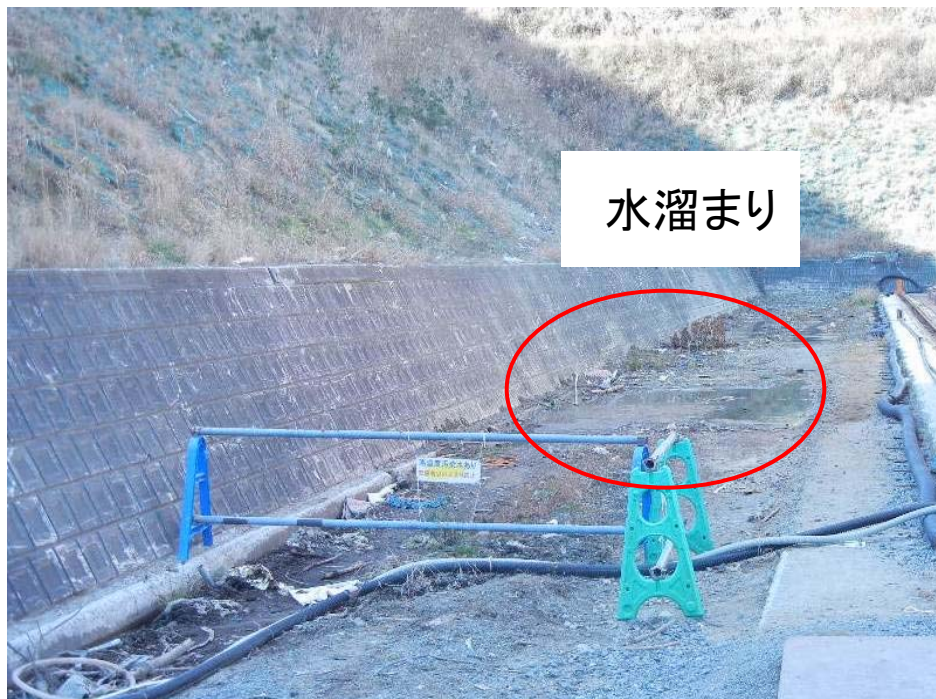
図3 ケーブル管路への浸水部写真
