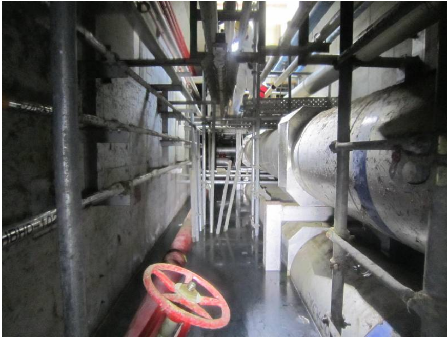
【写真①】 トレンチ内の水溜まりの状態
