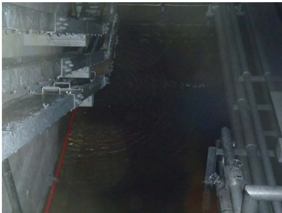
【写真②】 トレンチ内の水溜まりの状態
