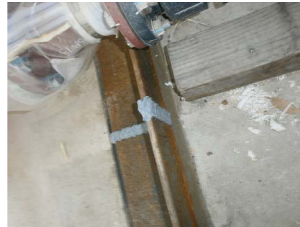
蒸発濃縮装置2ジャバラハウス
