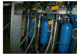
水圧制御ユニット ・機器には外観上異常なし
