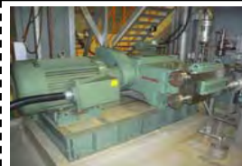
ほう酸水注入系ポンプ ・機器には外観上異常なし
