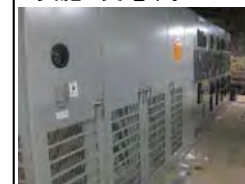
480Vパワーセンター ・P/C6B-1は盤全体被水し使用不可
