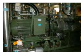
原子炉冷却材浄化系ポンプ ・機器には外観上異常なし
