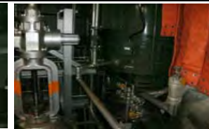
残留熱除去系ポンプ ・機器には外観上異常なし ・床面に滞留水あり
