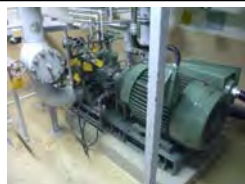
燃料プール冷却浄化系ポンプ ・両号機腐食(発錆)が若干認められるものの、機器には外観上異常なし (A)運転中、(B)待機中
