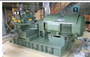
原子炉建屋補機冷却系ポンプ ・機器には外観上異常なし (A)運転中 (B)(C)待機中
