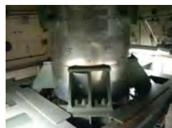
残留熱除去系熱交換器 ・機器には外観上異常なし
