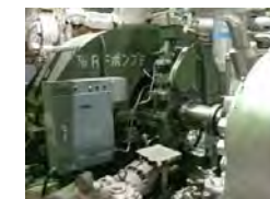
タービン駆動原子炉給水ポンプ ・機器には外観上異常なし
