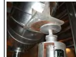
湿水分離器 ・保温外れ、サポートずれ有り
