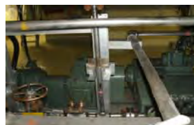
ほう酸水注入系ポンプ ・機器には外観上異常なし
