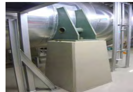
原子炉建屋補機冷却系熱交換器 ・機器には外観上異常なし
