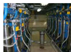
水圧制御ユニット ・機器には外観上異常なし
