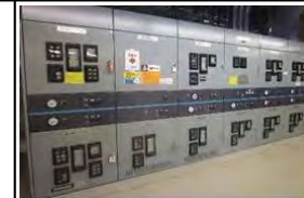
6.9kVメタクラ ・津波による浸水後に排水、溝設置、清掃等実施し受電中。
