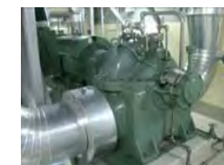
タービン建屋補機冷却系ポンプ ・機器には外観上異常なし
