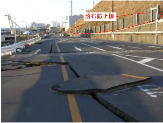
海側片車線が道路と平行に割れ段差が発生。西側の通行は可能。 3/17撮影
