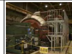
高圧タービン ・フロントスタンダード基礎ボルト近傍に亀裂あり
