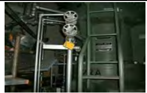
炉心スプレイ系ポンプ ・機器には外観上異常なし ・床面に滞留水あり ・同エリア壁面貫通部に漏洩痕
