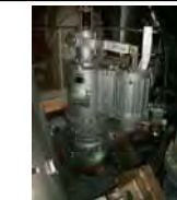
逃し安全弁 ・機器には外観上異常なし
