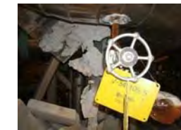
湿水分離器回り配管 ・No3湿水分離器ドレン配管から分岐する小口径配管が破損
