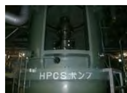
高圧炉心スプレイ系ポンプ ・機器には外観上異常なし
