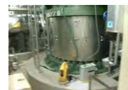
残留熱除去系ポンプ ・機器には外観上異常なし
