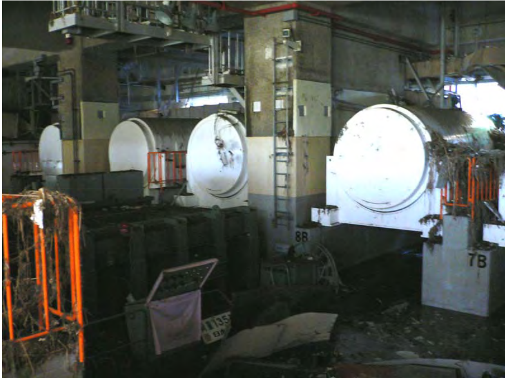
図3 乾式貯蔵キャスク保管建屋内の状況
