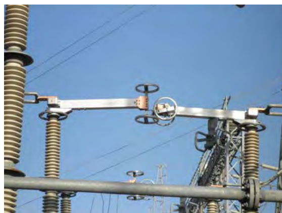
図 3 新福島変電所 大熊線 3 L 断路器
