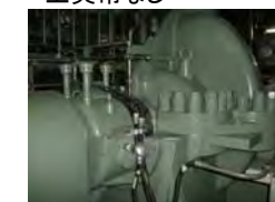
高圧復水ポンプ ・機器には外観上異常なし
