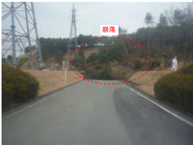
防災道路ではないが斜面崩落し道路が塞がれ通行不能。 3/20撮影
