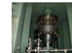
低圧復水ポンプ ・機器には外観上異常なし
