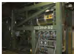
可燃性ガス濃度制御系 ・A系は機器には外観上異常なし ・B系(3階設置)は震災前よりB-2再結合器内冷却器に不具合あり
