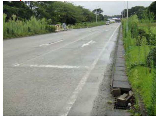
正門からの直線道路には特に異常なし。 8/26撮影
