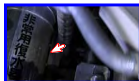
IC(B)凝縮水戻り配管
