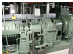
制御棒駆動水ポンプ ・機器には外観上異常なし
