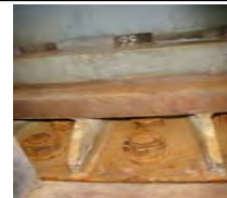
原子炉圧力容器支持スカート部 ・基礎ボルト部に錆があるものの、機器には外観上異常なし
