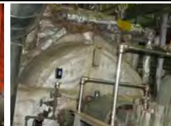
高圧注水系 ・機器には外観上異常なし ・床面に滞留水あり
