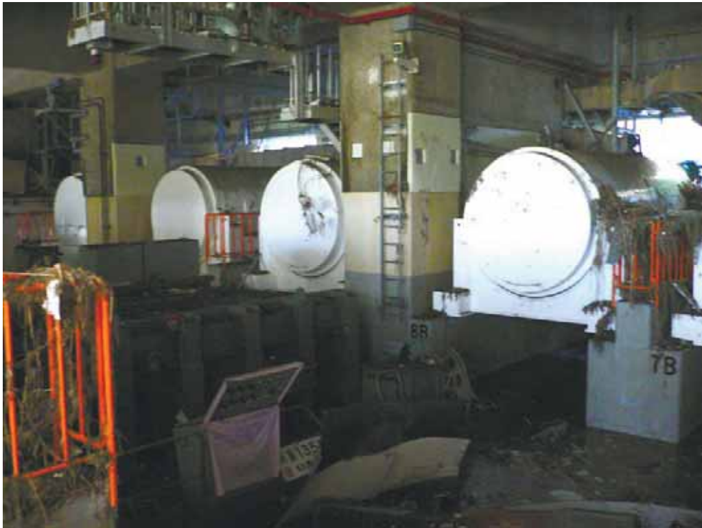
図 1 3 － 1 2 － 3 乾式貯蔵キャスク保管建屋内の状況
