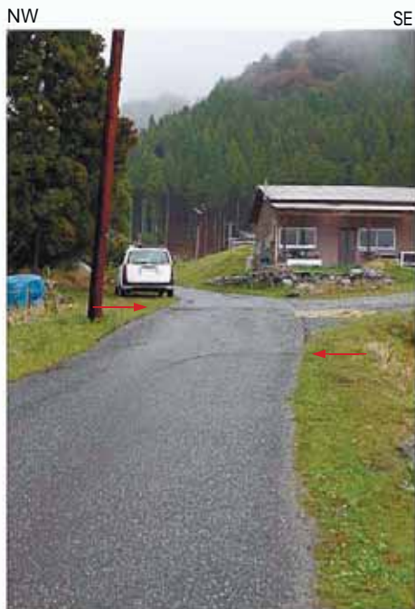
Loc.YnW-1 道路に直交方向のクラック (→) が認められ、路面は若干撓曲状を示す
