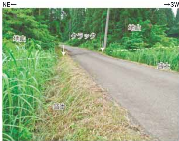
同上 クラックはN15Eの走向を示し、西側が10cm程度沈下している。
