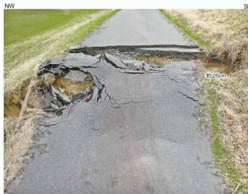
同左道路拡大 右ずれ約 25cm の水平変位が認められる。
