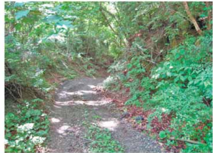
露頭及び路面に地震時における変位は認められない。
