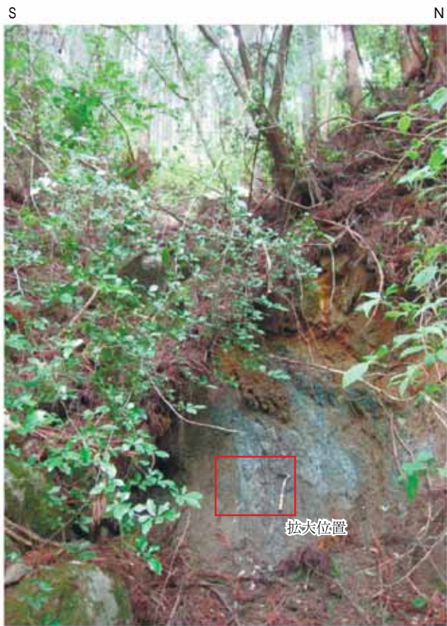
Loc.K100 リニアメントに対応する花崗岩類中の断層。 地震時における変位は認められない。
