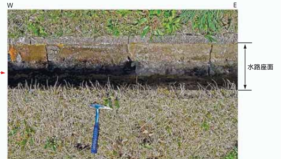
同左 用水路が破損して、水が地下に浸透している。
