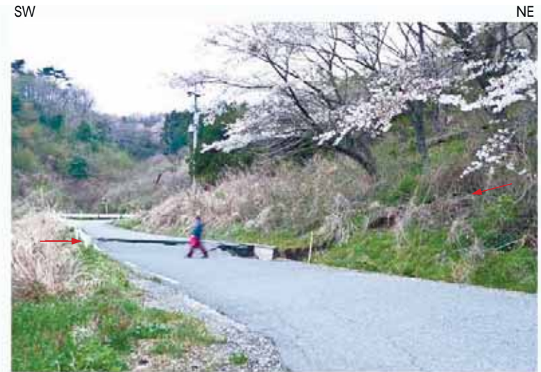
Loc.y-30 道路面に南東落ち約 50cm の上下変位が認められる。
