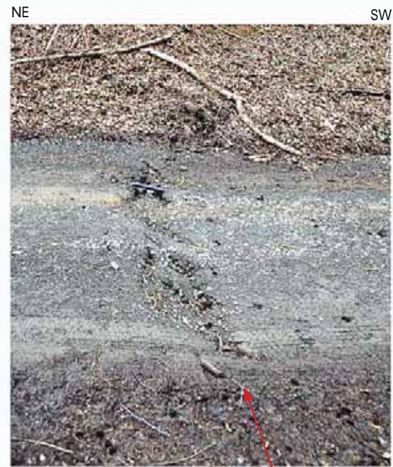
林道路面上にクラックが出現し、南落ち約 10 ~ 15cm の上下変位が認められる。
