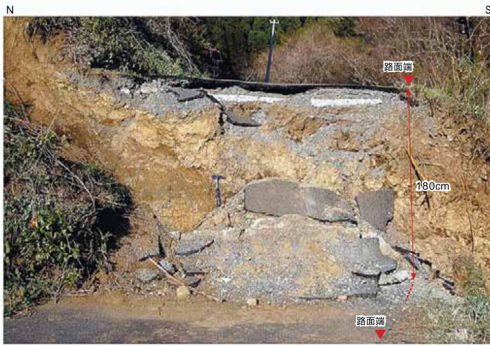
Loc.Id-18 道路面に出現した地震断層。西落ち約 180cm の上下変位が認められ、水平変位は不明瞭である。
