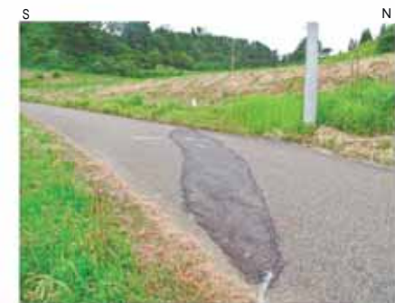
n地点: 道路舗装面上にN60W走向のクラックが認められる。1-3cm北西側沈下を示す。
