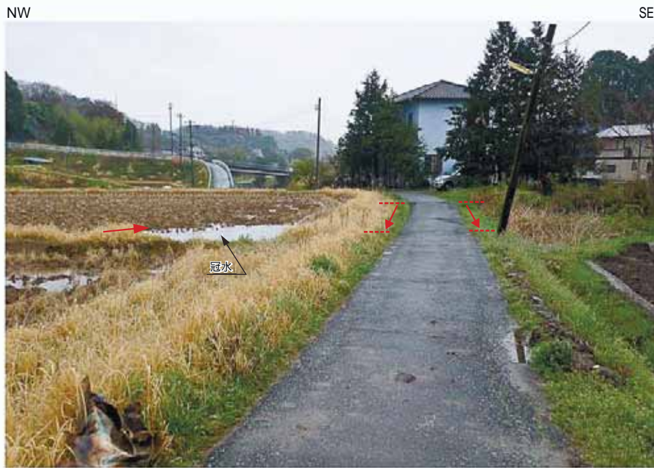
Loc.Y-21 L3 面上の路面，水田に撓曲変形。撓曲部の路面には開口クラックが認められる。
