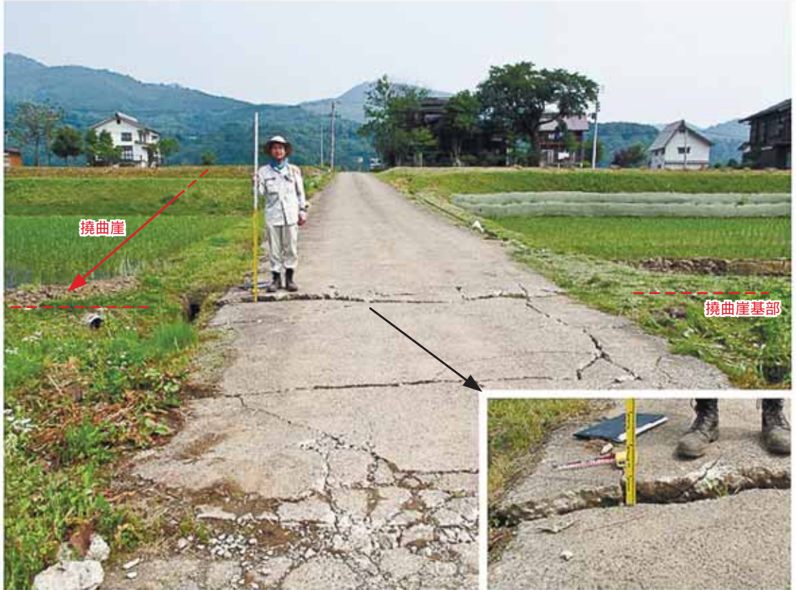
Loc. t01, 新潟県津南町亀岡 宮野原断層の撓曲崖基部に認められる南落ちのクラック 道路面に約8cmの南落ち上下変位が認められる。
