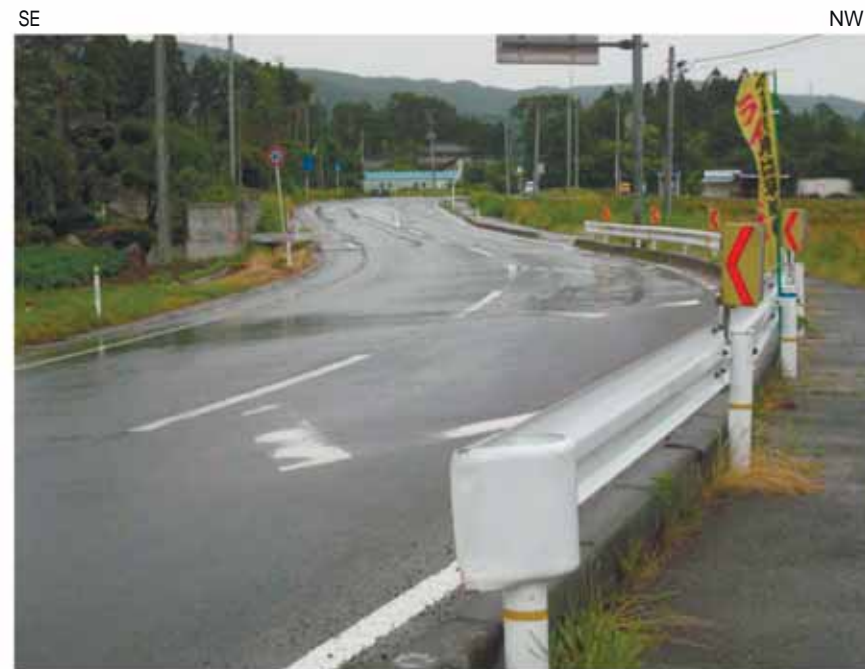
Loc.K206(いわき市大久三艘舟) リニアメント通過位置付近の路面に地震時における地変は認められない。
