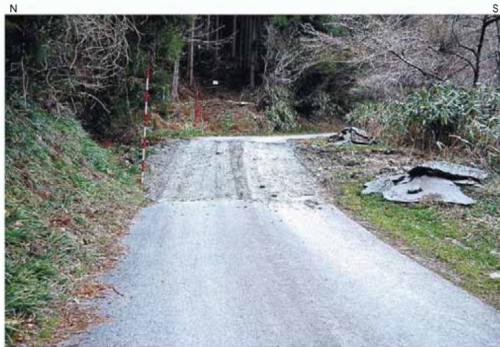
Loc.Id-9 道路路面に出現した地震断層。西落ち約90cmの上下変位が認められる。
