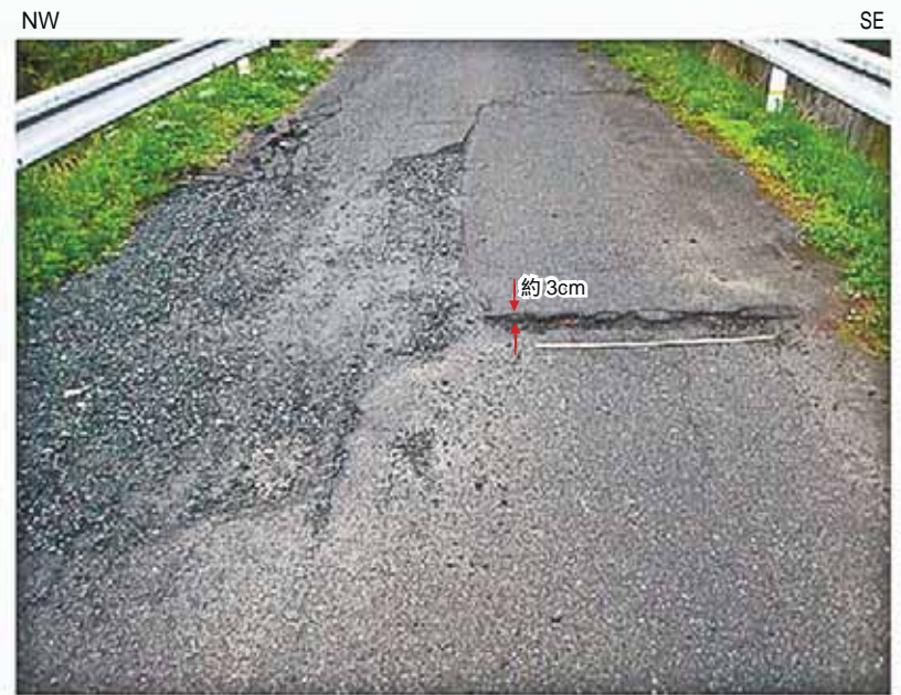
Loc.3p 路面に約 3 cm 南西落ちの上下変位が認められる。
