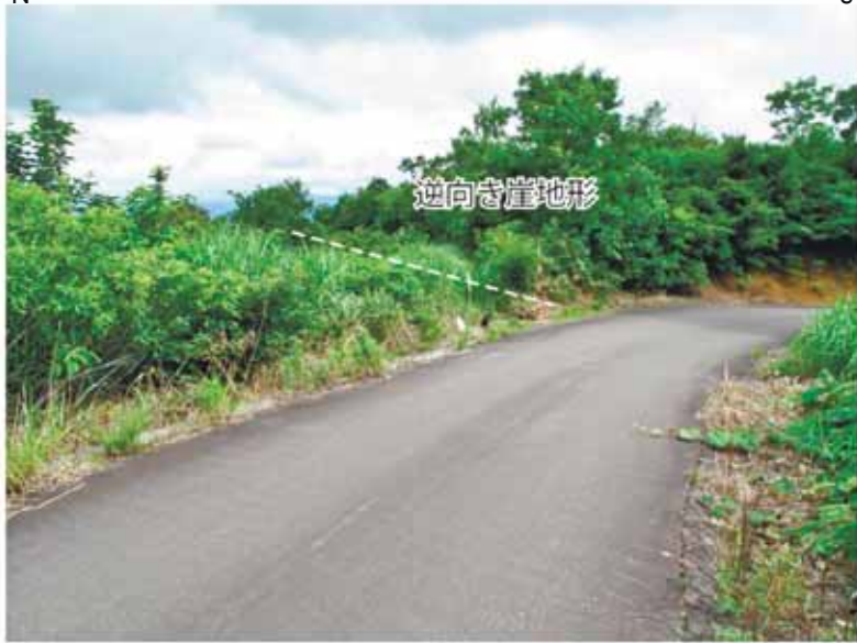
Loc.t138 平滝北 逆向き崖地形を横断する道路面上に変状は認められない .
