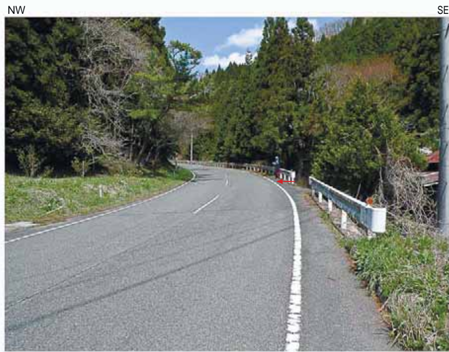
Loc.Y-1 道路に直交する小規模なクラック (→) が認められるものの、路面に変位・変形は認められない。
