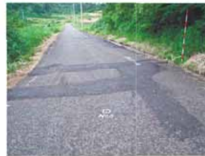
c地点: 側溝の変状の北北西側の道路 北西-南東方向のクラックが認められる。クラック東側が5-10cm沈下している。水田での沈下とは逆センスである。
