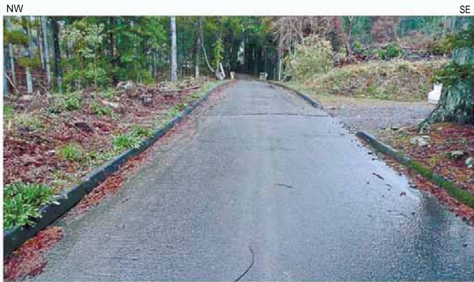
Loc.Y-3 路面は若干撓曲状を示し、道路直交方向にクラックが認められる。
