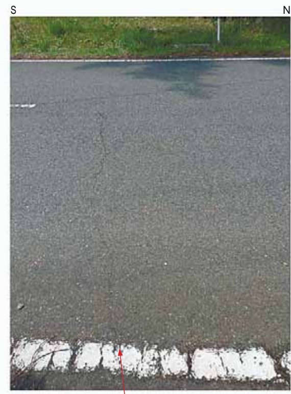
同左拡大 小規模なクラックが認められる
