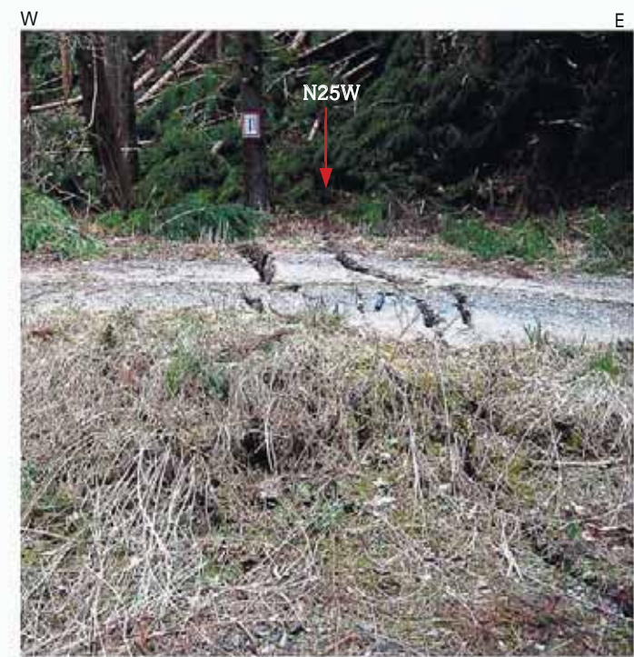
Loc.Id-5E(Id-5W の約 60m 東) 林道路面上に生じた開口クラック。西落ち約 60cm の上下変位が認められる。
