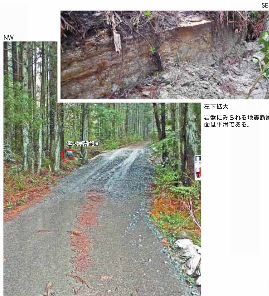
Loc.Y-7(いわき市遠野町上根本折松) 路面に南西落ち約 80cm の上下変位が認められる。
