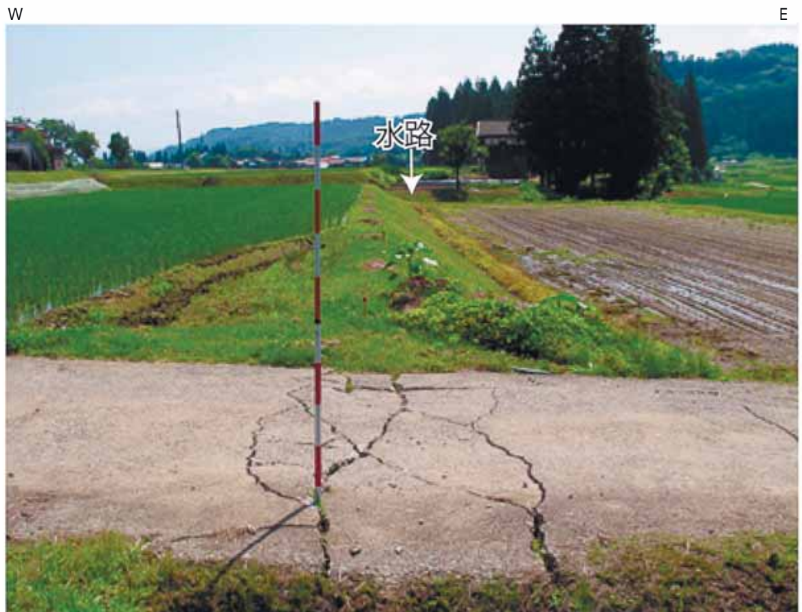
Loc. t02東側の畔に変状は認められず、さらに東に位置する水路にも変状は認められない。
