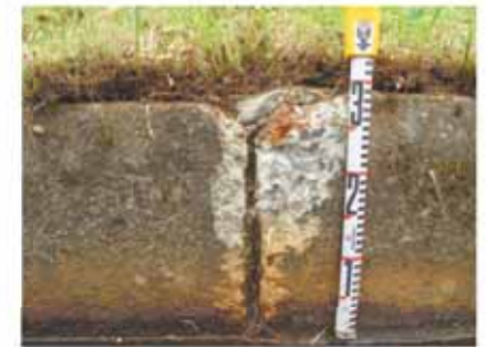
b地点: コンクリート製の側溝の継目に、新しい剥離跡と約3cmの東側上りの変位が認められた。
