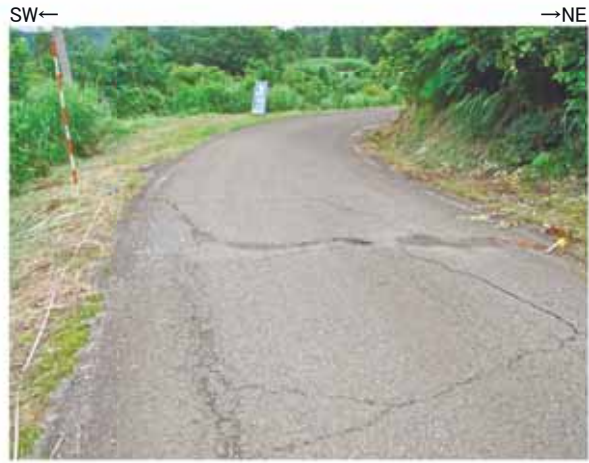
北側クラック N40～60W走向で南西側(写真手前側)が約1cm沈下している。
