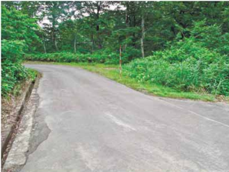
Loc.t142 逆向き崖地形を横断する道路面上に変状は認められない。
