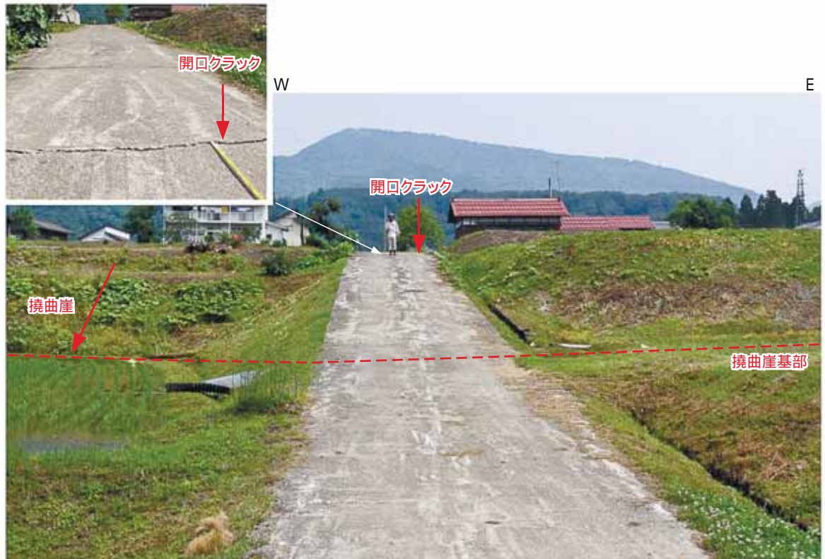
Loc. t02. 新潟県津南町亀岡 撓曲崖上部に認められる開口クラック。 幅約3cmの開口部が認められ、道路面は約1cm南側低下を示す。
