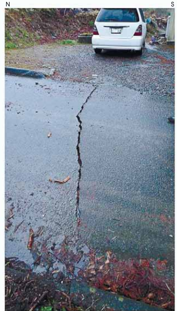
同左拡大 道路に直交する開口クラックが認められる。
