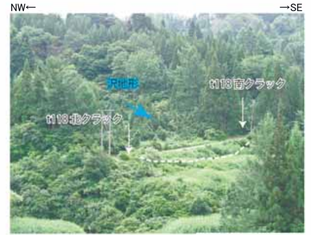
Loc.t118 沢地形を盛土して道路が敷設され(白線部分)、北及び南のクラックにはこの盛土区間と地山との境界で発生していることから、盛土部の沈下により、クラックが発生した可能性が高い。
