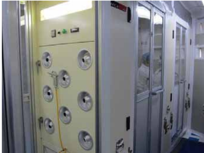
撮影日 : 平成23年7月22日 13時半頃 場所 : エアシャワー
