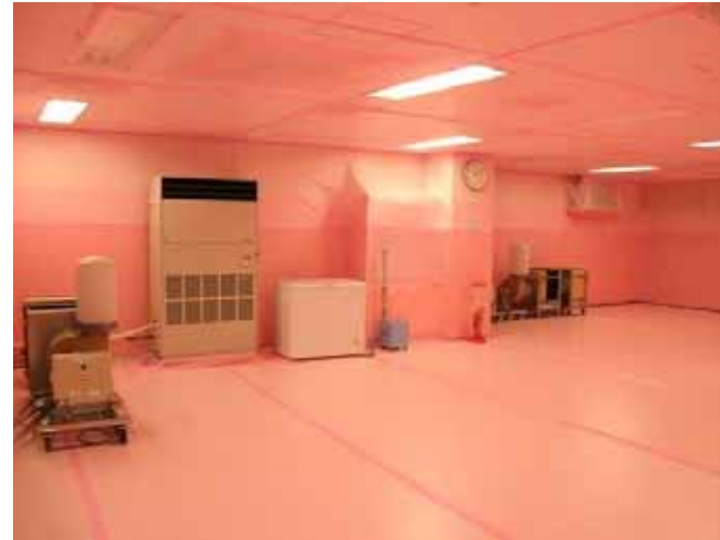
撮影日 : 平成23年7月21日 11時半頃 場所 : 休憩所内 設備は左から局所排風機、エアコン、 冷凍庫、ダストサンブラ、消火器、局所排風機
