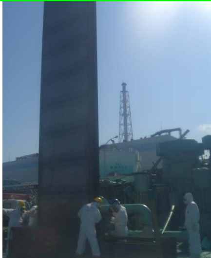
補機冷却用海水ポンプ室角落とし設置 [既実施]（2号機）（5/24完了）
