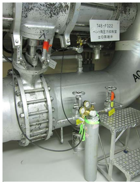
弁駆動用の予備ポンペ設置状況(訓練)
