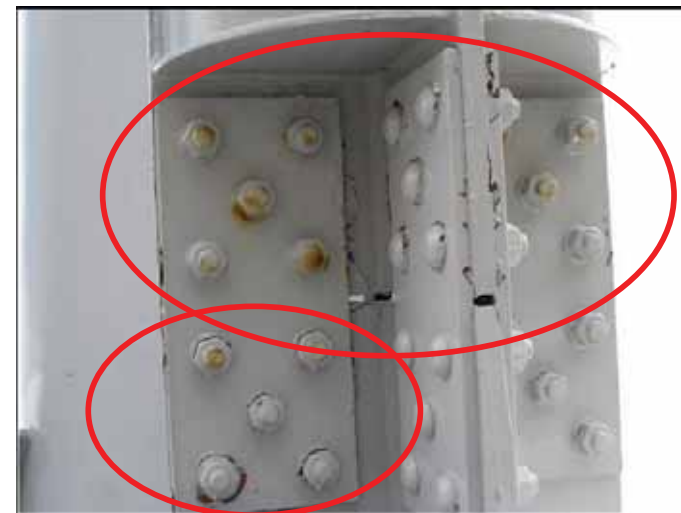
⑤ 斜材接合部 塗膜剥離
