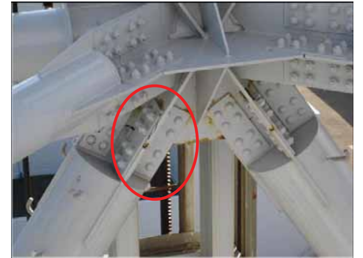
② 斜材接合部 塗膜剥離
