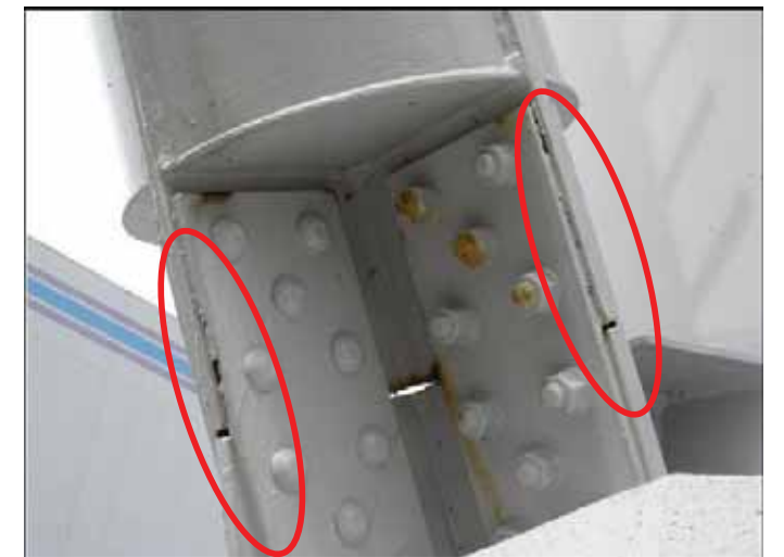
⑥ 斜材接合部 塗膜剥離
