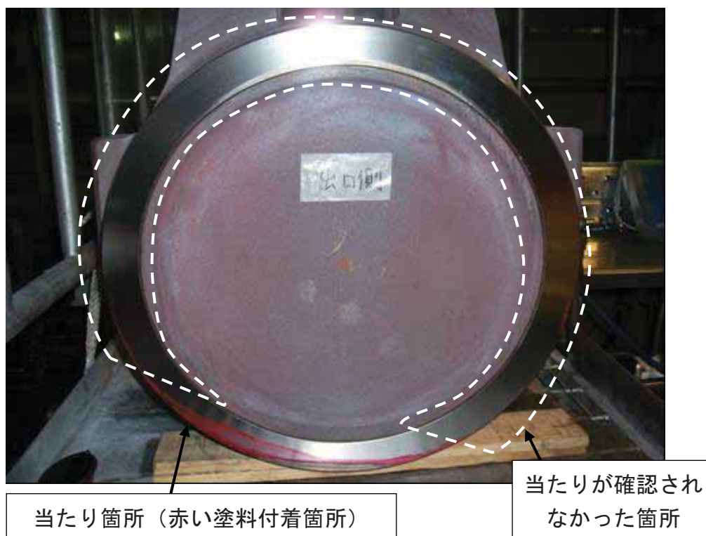
図-1 T/D RFP吐出弁(B)の当たり状況 (点検前)
