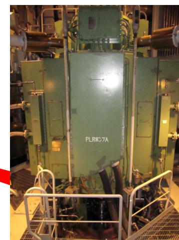
原子炉再循環ポンプ 電動機(2台)
