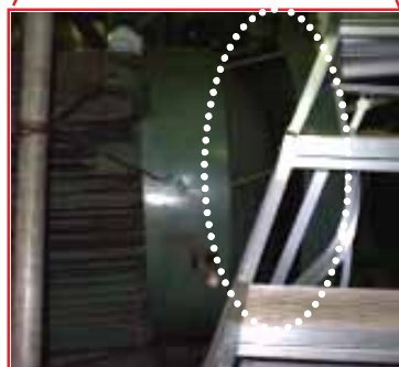
上部ファンカバーの変形
