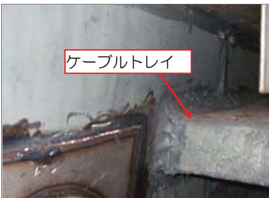
ケーブルトレイによる壁貫通部
