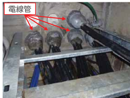
電線管による壁貫通部
