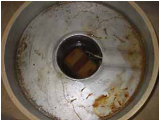
放射線モニタ検出器の水没状況
