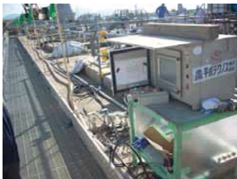
モルタル注入操作盤とモルタル注入ホース
