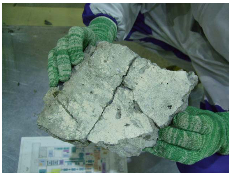
付図-9.1 落下したコンクリート片
