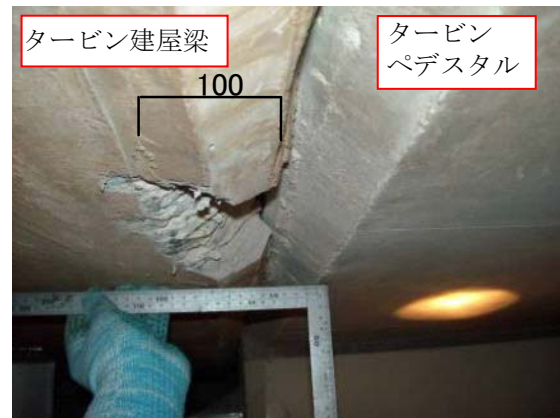
(2)剥落状況写真
