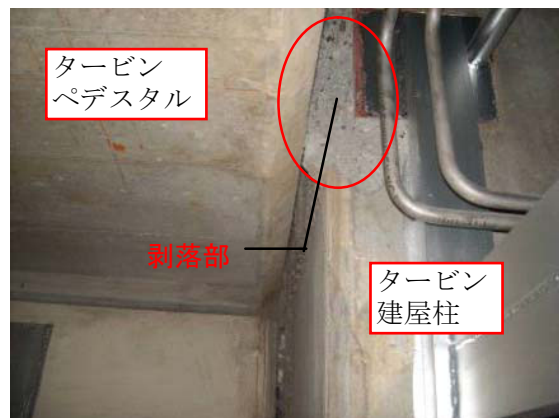
(2)剥落状況写真
