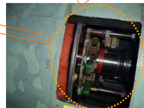
励磁機点検口
