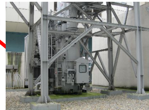
所内変圧器の外観
