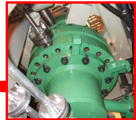
インターナルポンプ 電動機(10台)
