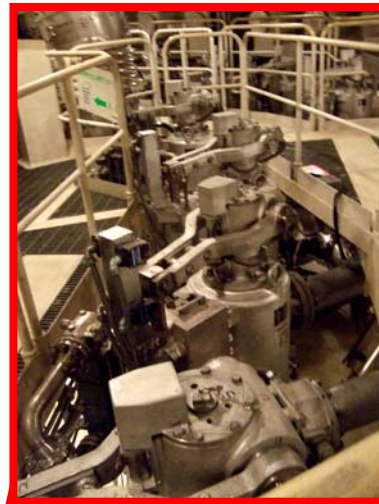
主蒸気逃し 安全弁(18台)
