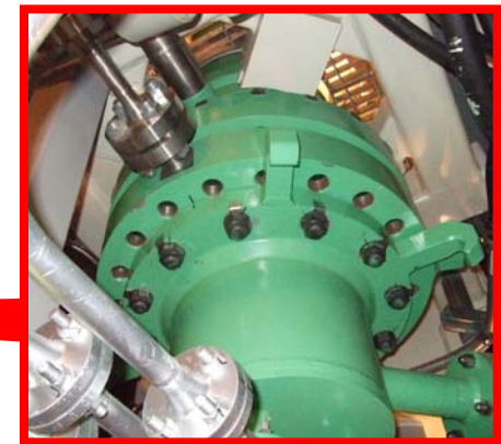
インターナルポンプ 電動機(10台)
