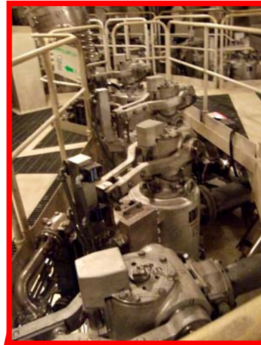
主蒸気逃し 安全弁(18台)
