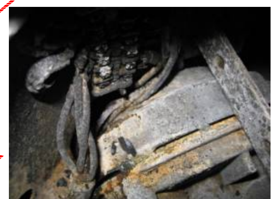
⑧モータカバー上部と中継端子台 ・モータカバーに焼痕
