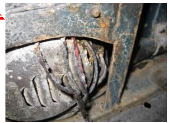
⑨モータカバー裏側 ・中継端子台につながる線に焼痕 ・中継端子台につながる線の結束バンド が焼失
