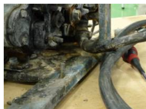
⑦溶接パワーケーブル及び接続部 焼損程度は軽微
