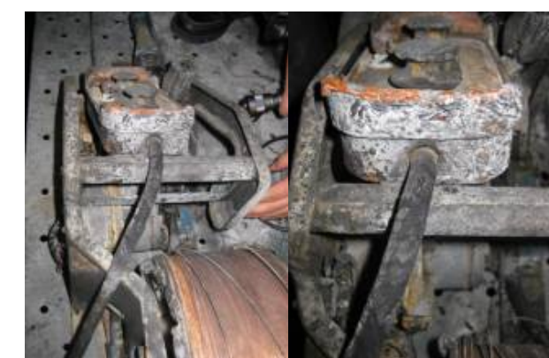
④リモコン部 ・リモコンボックスに焼痕 ・リモコンケーブルの被覆ゴムが炭化
