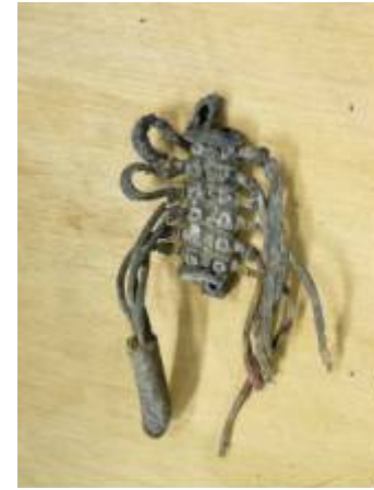
②中継端子台 上部の損傷が激しい。 発熱・着火した痕跡は判別できない
