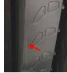
第13段タービン側シュラウドリング
