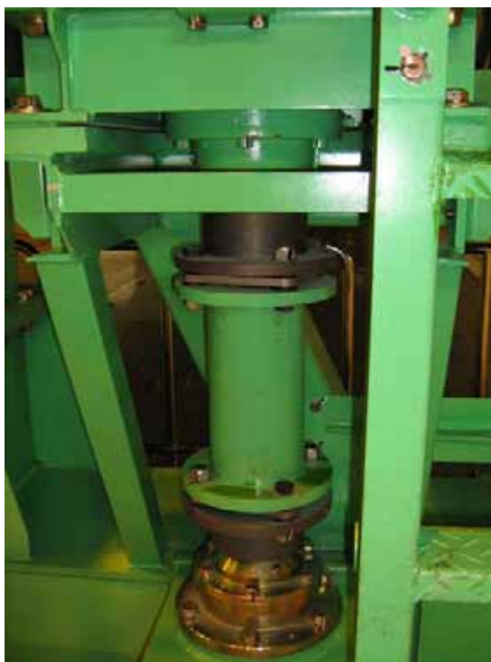
6号機シャフトカップリング
