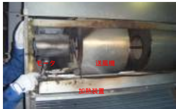
空調機パッケージ内部
