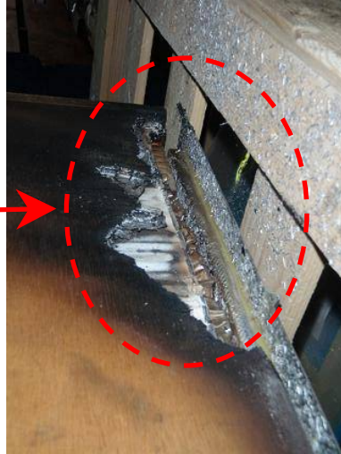
フィルタ側面 焼損部拡大
