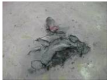
潤滑剤スプレー缶による 床面の焼損
