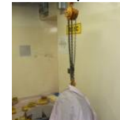
ポンプ吐出カバー 消火剤による汚れ有り
