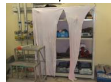
部品棚廻り 養生シート溶融 床面(ブリキ板)焼け跡有り
