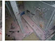
空調機左側板と立てかけ られていた鉄板との間の 塗装が損傷していたが、 鉄板の上端を境にそれより 上部の空調機側板の損 傷は軽度だった
