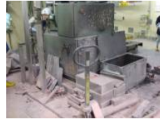
危険物保管箱(出火元)廻り
