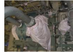
ポンプ本体廻り 消火剤による汚れ有り シート類に焼け跡無し
