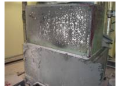
空調機外板焼損有り
