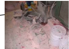
ポンプ分解部品廻り 床面(ブリキ板)焼け跡有り
