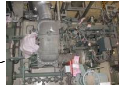
タービン・主要弁廻り 消火剤による汚れ有り シート類に焼け跡無し
