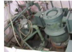
付属設備廻り 消火剤による汚れ有り
