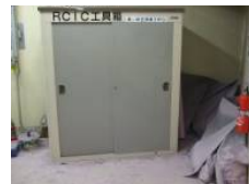
工具箱 消火剤による汚れ有り 箱扉部に焼け跡無し
