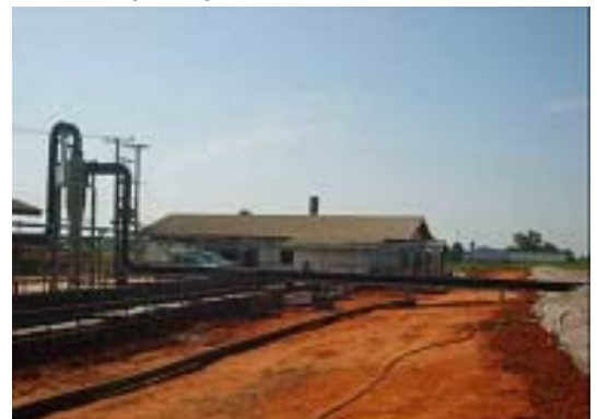
(参考) メタン回収設備
