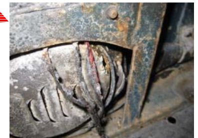
モータカバー裏側 ・中継端子台につながる線に燃烧痕 ・中継端子台につながる線の結束バンド が焼失
