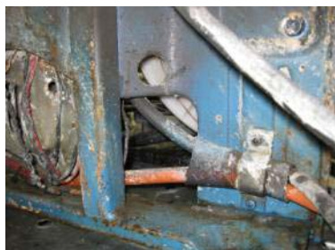
ガスホース及び制御ケーブル固縛部 ・ガスホース(オレンジ色)及び 制御ケーブル(青)共軽微な焼け焦げ
