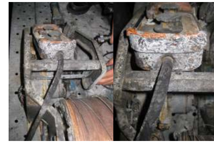
リモコン部 ・リモコンボックスに燃烧痕 ・リモコンケーブルの被覆ゴムが炭化
