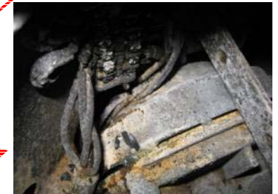
モータカバー上部と中継端子台 ・モータカバーに燃烧痕
