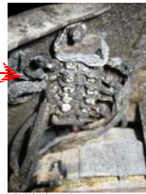
中継端子台 ・中継端子台カバーの痕跡は確認 できません ・中継端子台には燃烧痕 ・中継端子台に接続されている線に 燃烧痕
