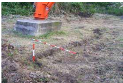
「支持物」の地盤変状
