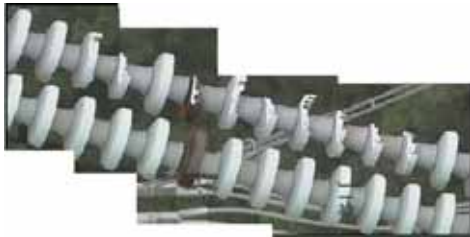
「がいし」の破損 18基（改修済）
