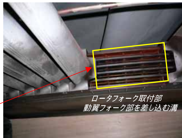
第14段ロータの外観 (非破壊検査の実施部位を上面から見る)
